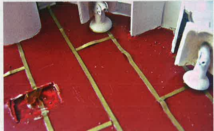
Ein Baufehler im Linoleumdeck
