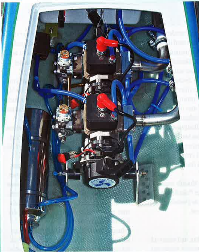
Motorraum mit den Chung-Yang-Motoren, dem Edelstahltank und den Kühlwasserleitungen
